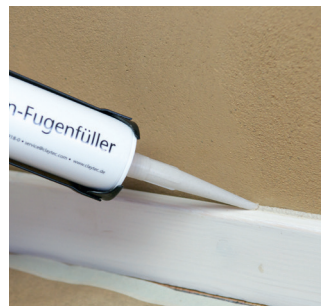
Fugenfüllung mit natur-weiß an einer Sockelleiste
