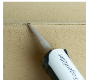
Füllung eines Abrisses zwischen Decken- und Wandbauteil
