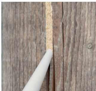
Füllung eines Schwindrisses in einem Fachwerkbalken
